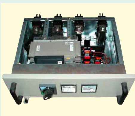
7 Ausführungsbeispiel: Einschub bis 400/320 A mit Leistungsschalter (Schutzart IP 30)
