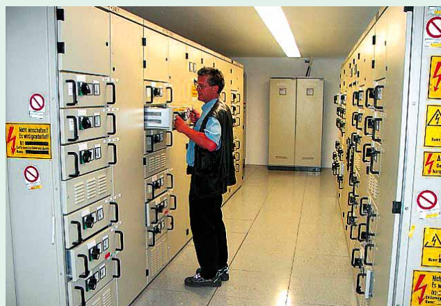
4 NS-Schaltanlage, Typ MoNA 5000 für den Kraftwerkeigenbedarf
