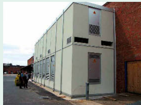
2 Betonfertigungsstationen für 7 Transformatoren 1600 kVA und 6 NS-Schaltanlagen in Einschubtechnik (MoNA 5000)
