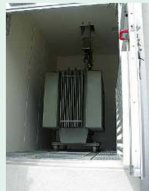
3 Transformator 1600 kVA, 6 kV/400 V, mit gießharz-isolierter Schienenverbindung (2500 A) zur Schaltanlage
