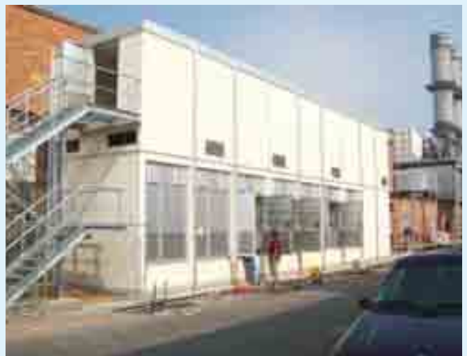
③ Beispiel für eine typgeprüfte Schaltanlage als Fertigstation ▶
