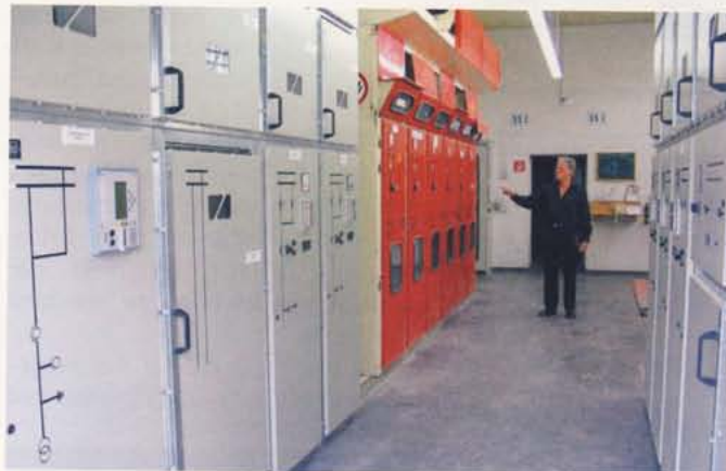
Bild 4. Beispiel einer schrittweisen Umrüstung der MS-Schaltfelder (Umspannungswerk 2 der SW Waiblingen). Im Hintergrund (rot) noch ein Anlagenstück des Baujahres 1975
