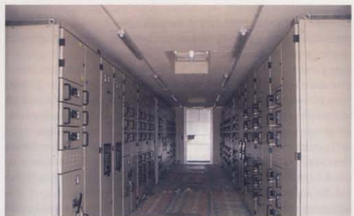
Bild 4: Niederspannungs-Schaltanlagen (Typ MoNA 5000 [7]) in der Betonstation
