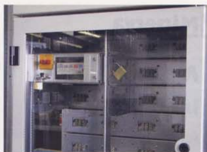
Abb. 2. Schubeinsatztechnik der neuen, dritten Generation. Beispiel eines Schubeinsatzes mit elektronischem Motormanagement Simocode pro C (Büttner, Kase, 2006)
