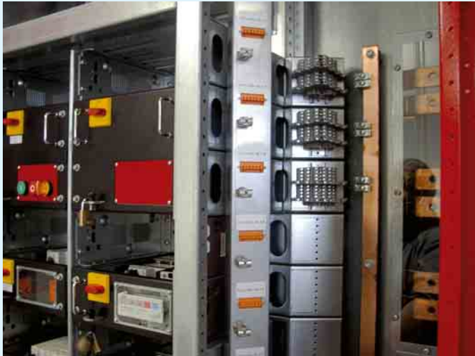
② Mehrfach-Feldbusverteiler im Kabelanschlußraum
