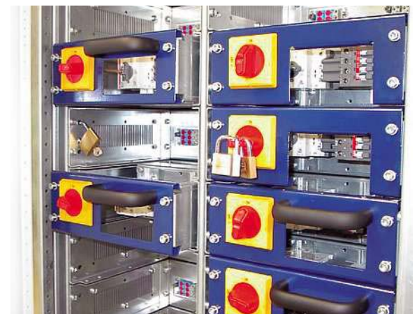
Bild 2: Verschiedene Positionen der Schubeinsätze; rechts: Betriebsstellung, Prüfstellung, links: Trennstellung, Absetzstellung.
